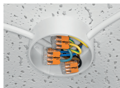
Leuchtenverteilung in Deckenbaldachin
